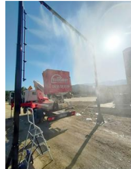
Rampe d'aspersion sur les camions après rechargement en OMR
